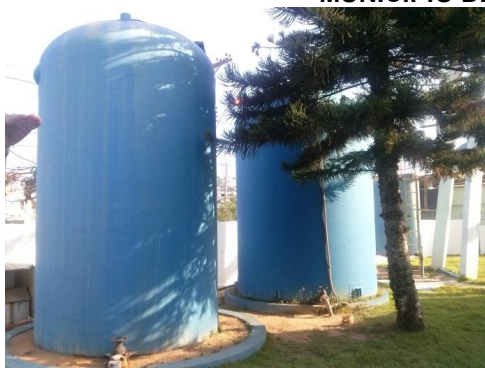
Figura 5.7 – Reservatório de Sulfato de Alumínio
