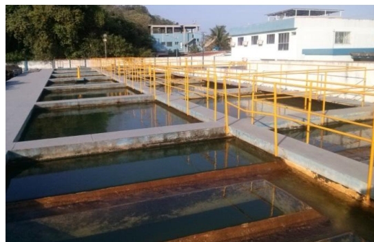
Figura 5.6 – ETA Principal sistema de tratamento
