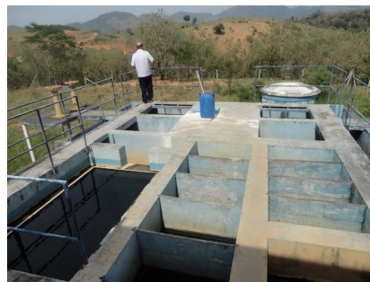
Figura 5.47 – Tratamento ETA São João da Lancha
