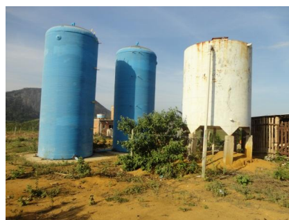
Figura 5.23 – Reservatórios Bela Vista
