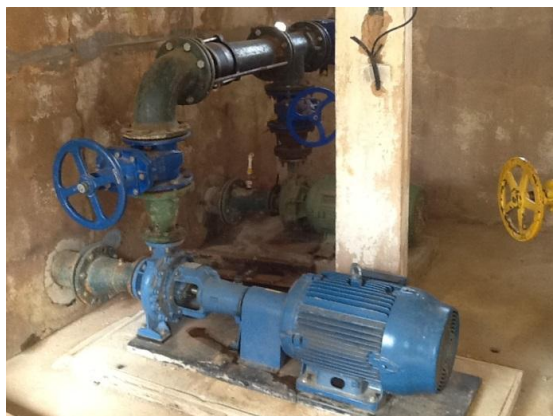
Figura 5.41 – Bomba de Sucção ETA Graúna
