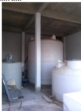
Figura 5.8 – Reservatório de Cloro
