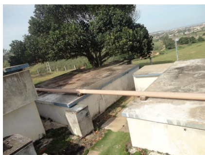
Figura 5.22 – Tanques de Contato ETA Gomes
