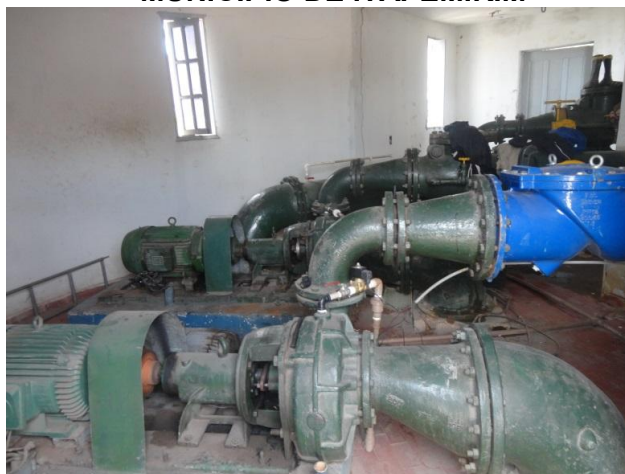
Figura 5.3 – Bombas Utilizadas para o Recalque de Água Bruta
