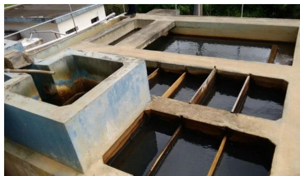
Figura 5.44 – Vista Floculador e Decantador ETA Garrafão
