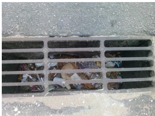
Figura 8.1 – Falta de Manutenção Boca de Lobo
