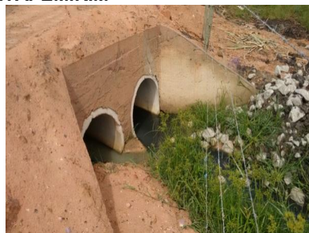
Figura 8.8 – Manilhas de rede pluvial recebendo esgoto em Campo Acima
