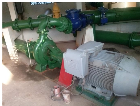
Figura 5.14 – ETA Principal, Bombas e Elevação de Água Tratada
