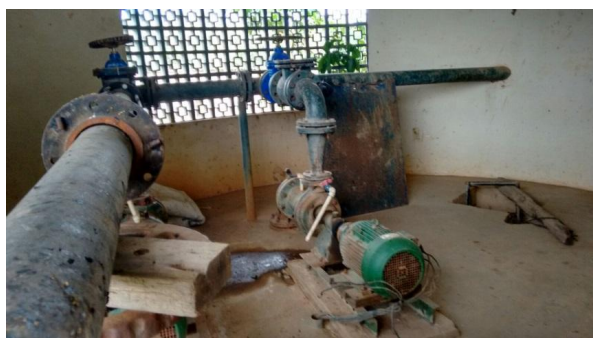
Figura 5.37 – Bomba ETA Garrafão
