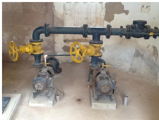
Figura 5.42 – Bomba Recalque de Água Bruta
