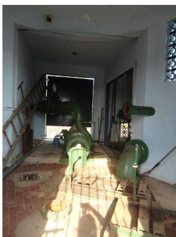
Figura 5.17 – Bomba de Recalque Captação da ETA Gomes
