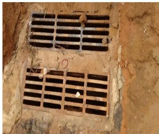
Figura 8.6 – Bocas de lobo em Namytyala
