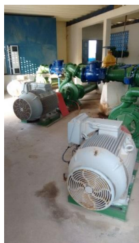
Figura 5.13 – ETA Principal, Bombas e Elevação de Água Tratada
