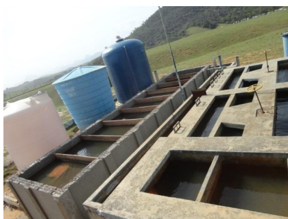
Figura 5.20 – Novo Floculador na ETA Gomes
