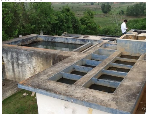
Figura 5.39 – Vista Floculador e Decantador ETA Garrafão
