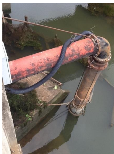
Figura 5.2 – Detalhe da Captação
