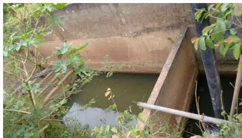
Figura 5.36 – Detalhe da Captação
