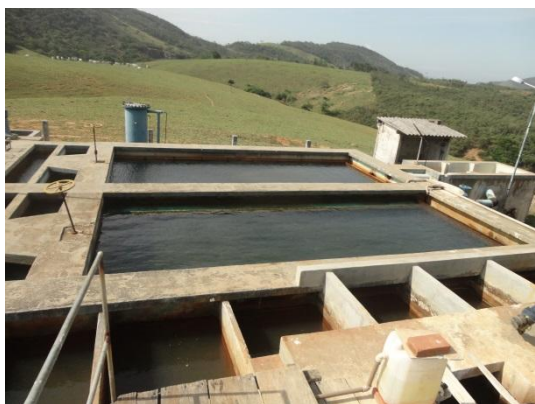
Figura 5.18 – Vista do Floculador e Decantador da ETA Gomes
