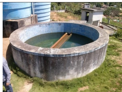
Figura 5.29 – Filtro ETA Limão
