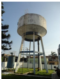
Figura 5.9 – Reservatório para Lavagem dos Filtros
