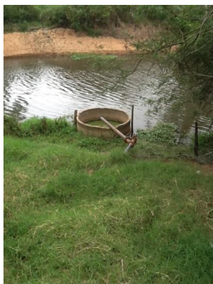
Figura 5.30 – Captação Principal Manancial Rio Muqui
