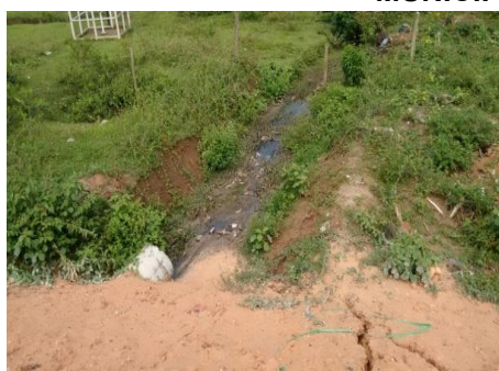
Figura 8.7 – Ligações clandestina de esgoto na rede de drenagem pluvial em Campo Acima
